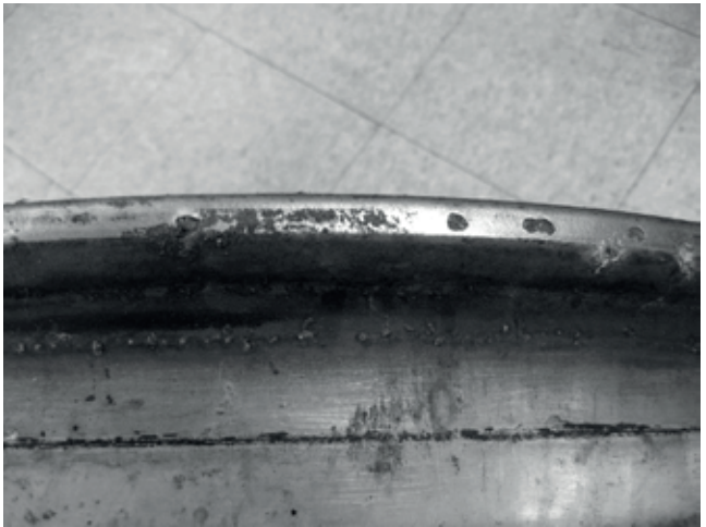
Bilde 13-37 Akseptabel slitasje og grop dannelse
