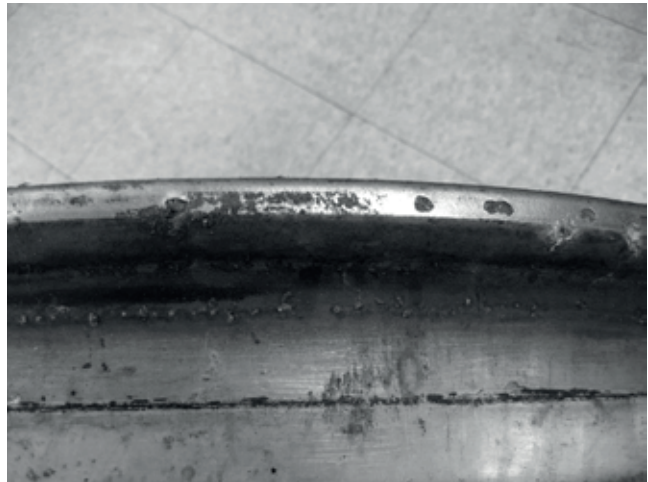
Zdjęcie 13-37 Dopuszczalna korozja wżerowa i zużycie
